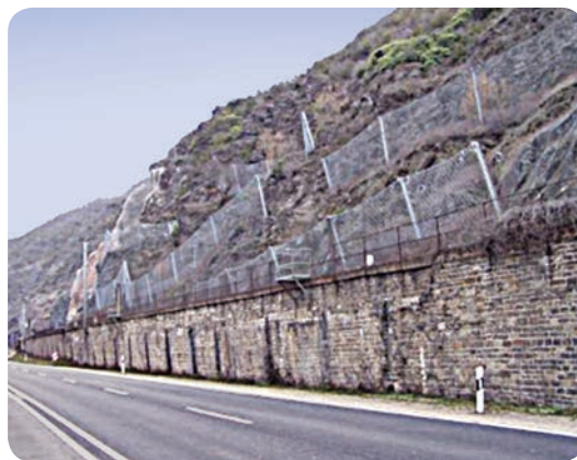
Рис. 51. Защита дороги от камнепадов, оползней
