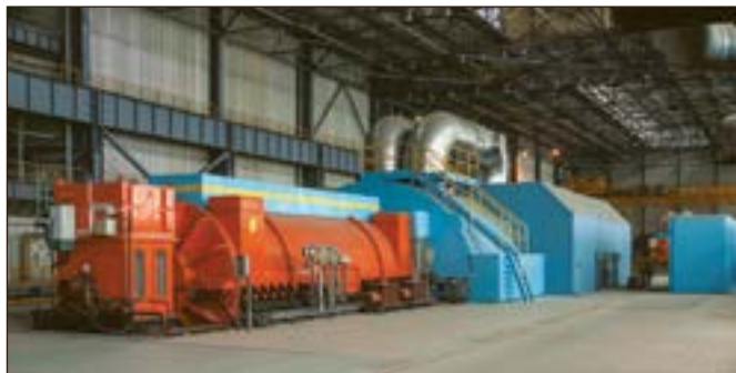
249-сурет. Электрстансының мәшине залы. Бу генераторы
