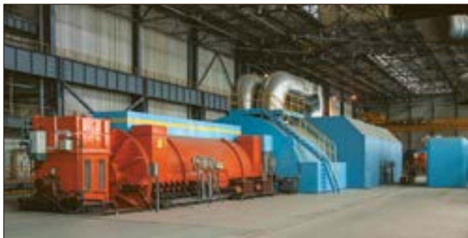
Рис. 249. Машинный зал электростанции. Парогенератор
