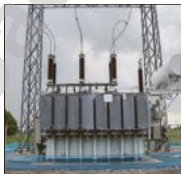
Рис. 253. Силовой трансформатор на подстанции
