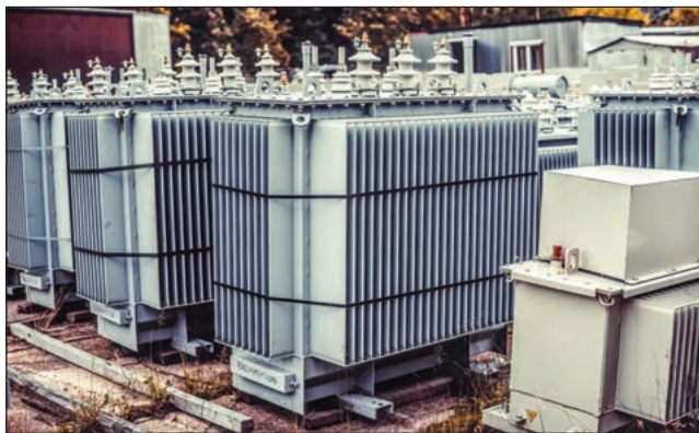
34-сурет. Күш трансформаторы, ҚР, Кентау қаласы
