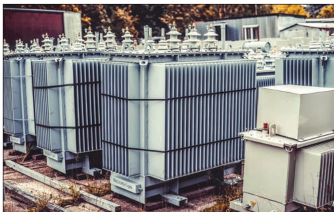
Рис. 34. Силовой трансформатор, произведен в г. Кентау РК
