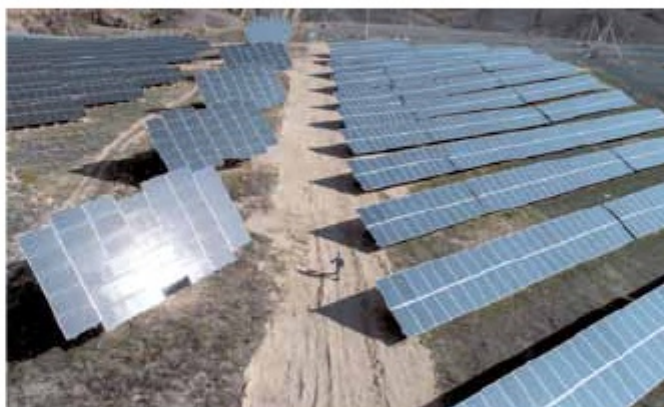
Рис. 2.8.2. Солнечные батареи (Алматинская область, г. Капшагай)
