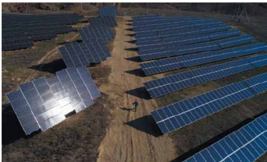
Рис. 2.5.2. Солнечные батареи (Алматинская область, г. Капшагай)
